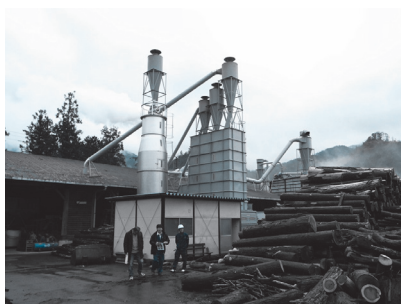
木材市場のペレット製造施設
