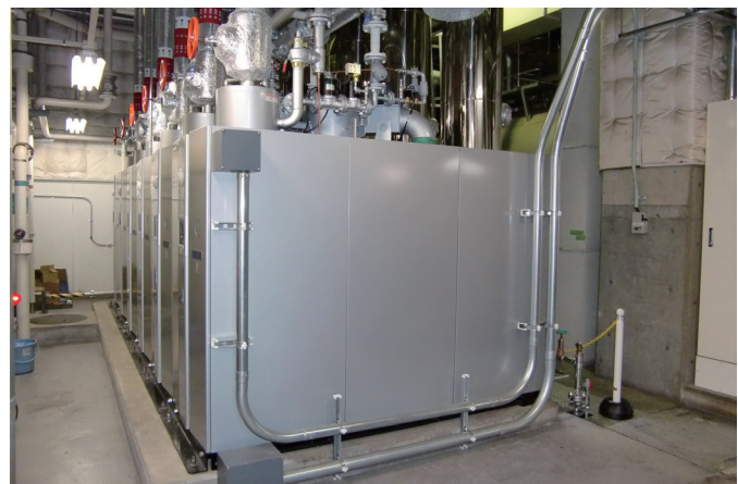
ボイラー改修後
