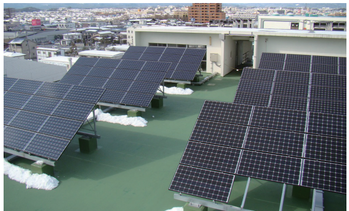
郡山女子大学 太陽光発電設備
