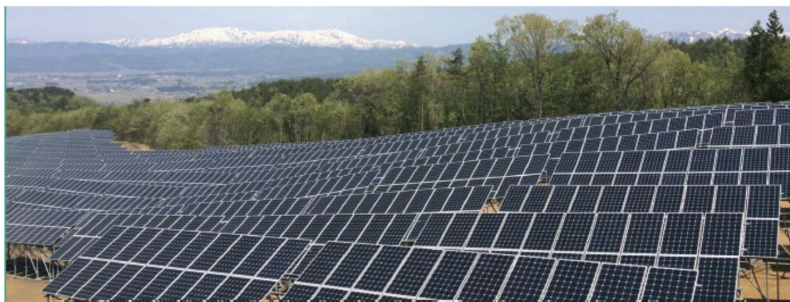
雄国太陽光発電所（提供：会津電力）
