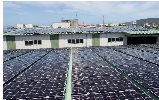
太陽光発電所の設置 (5ヶ所・出力合計約670kW)
