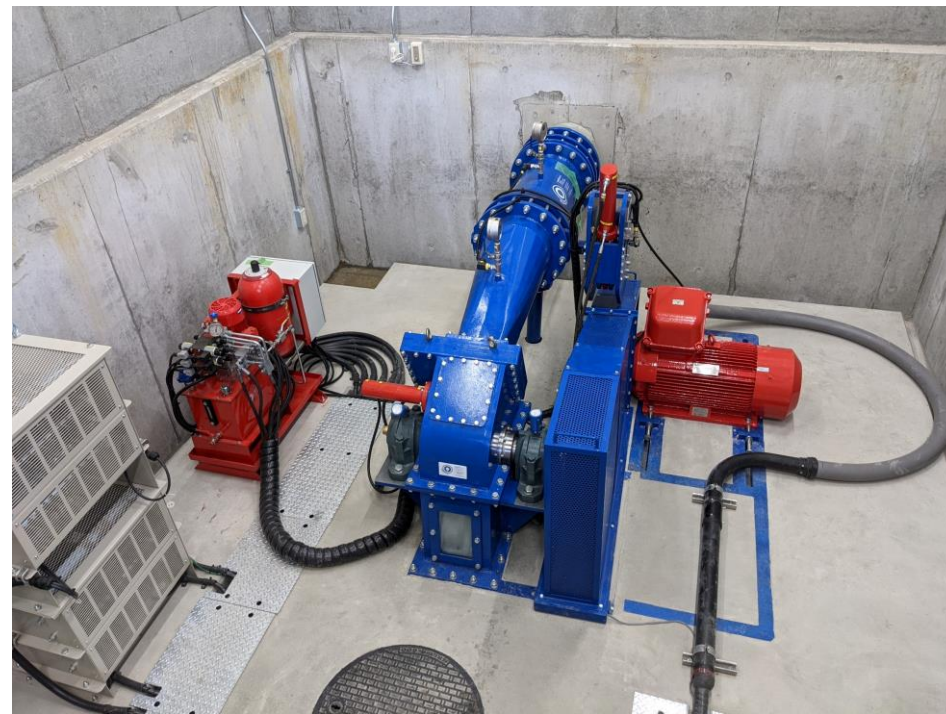
●岐阜県飛騨市宮川町発電所
