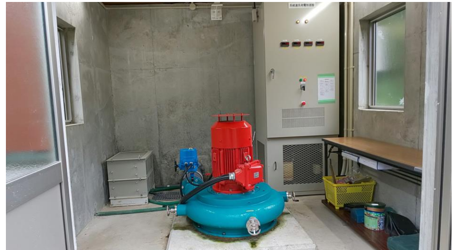
住宅にすると約40軒分の電力量
