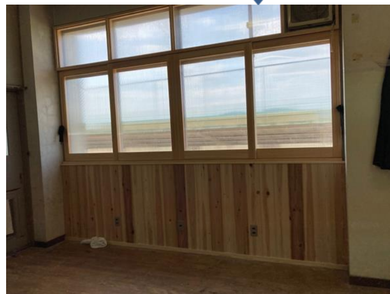
この部分だけ壁断熱
