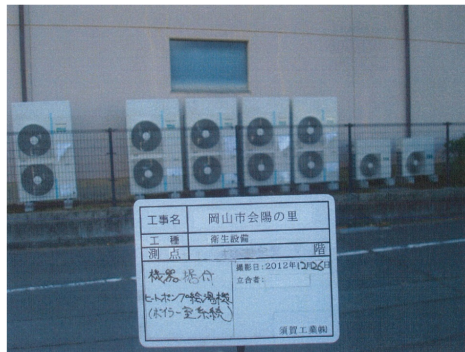
ヒートポンプ給湯機
